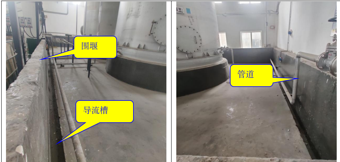
废液储罐导流槽、围堰、输送管道
