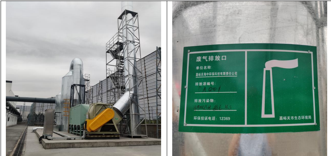
废气处理装置
