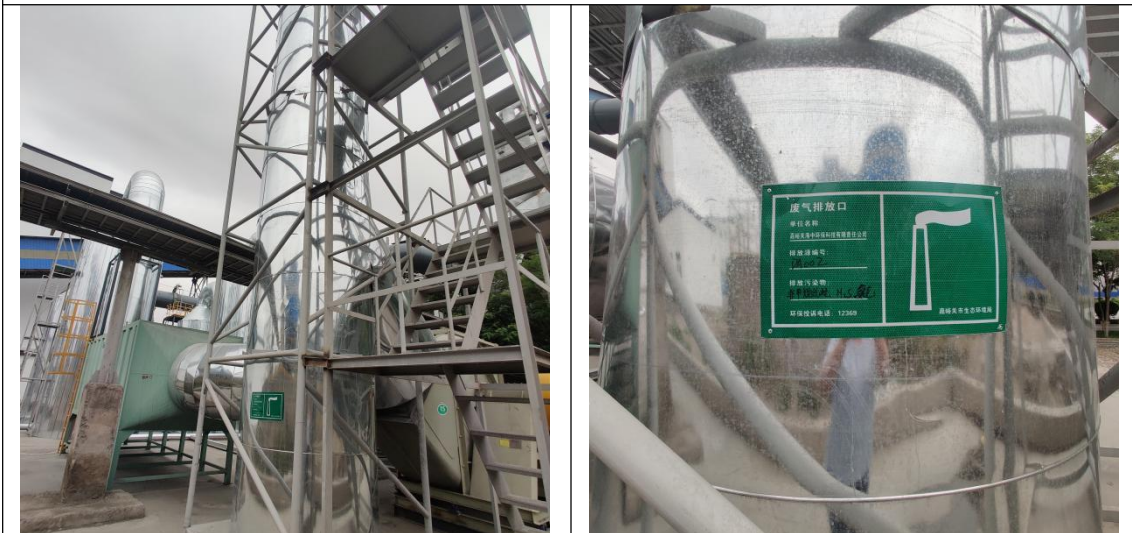
废气处理装置
