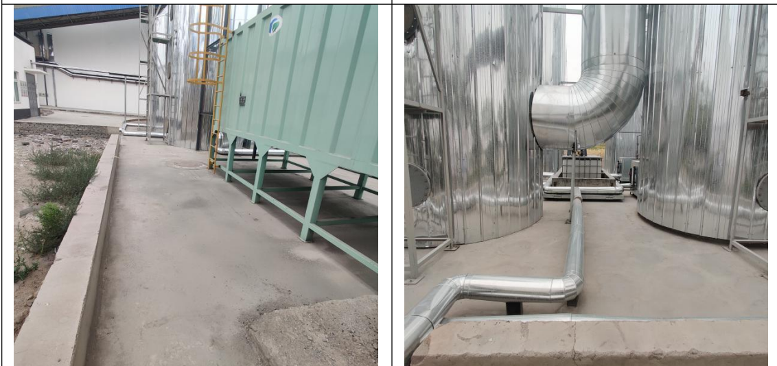
废气处理装置周边围堰及防渗
