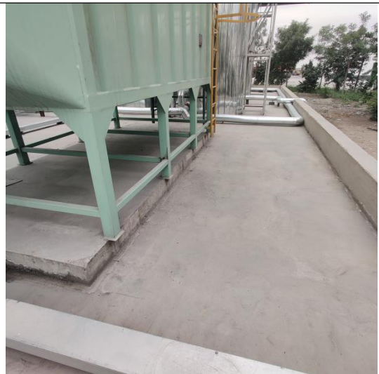
废气处理装置周边围堰及防渗
