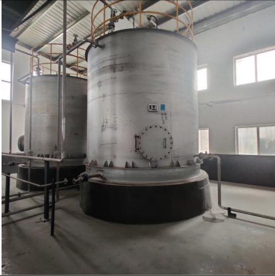
废液处置车间废液储罐
