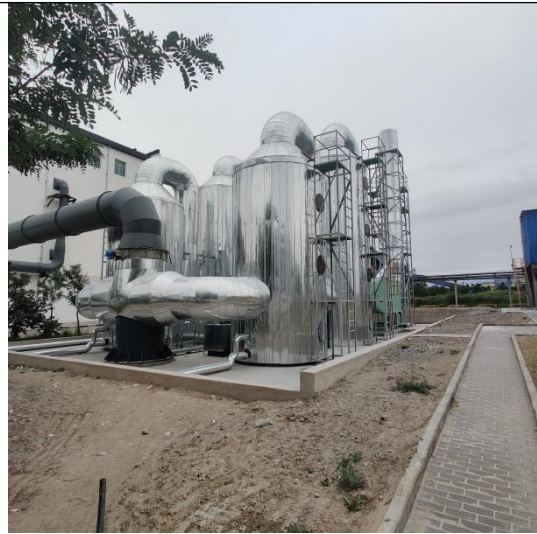
废气处理装置
